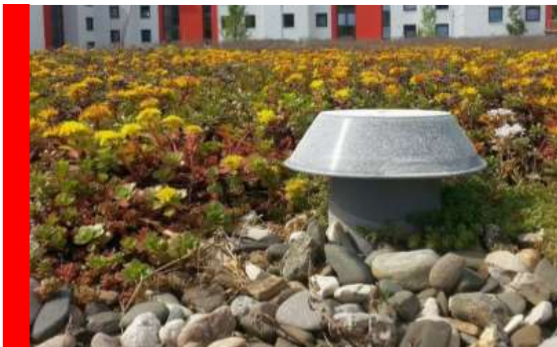
Eine Dachbegrünung hält bei Starkregen Wasser zurück und sorgt bei Hitze für Temperatenausgleich.
